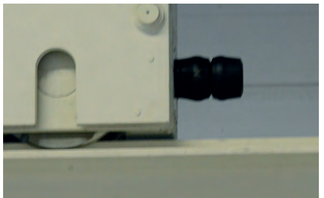
► Ammortizzazione di arresto d'emergenza su una gru a portale
